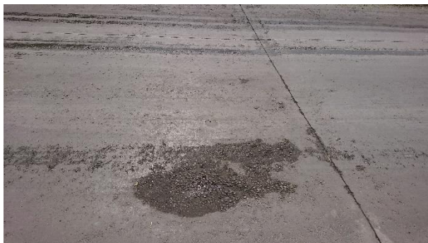
Rys. 62. Złuszczenie betonu wałowanego w wyniku niedostatecznej pielęgnacji i szybkiego przeschnięcia podczas wbudowania. Wyraźnie widać porowatość betonu i wyższą nasiąkliwość warstwy po złuszczeniu. Zdjęcie autora.
