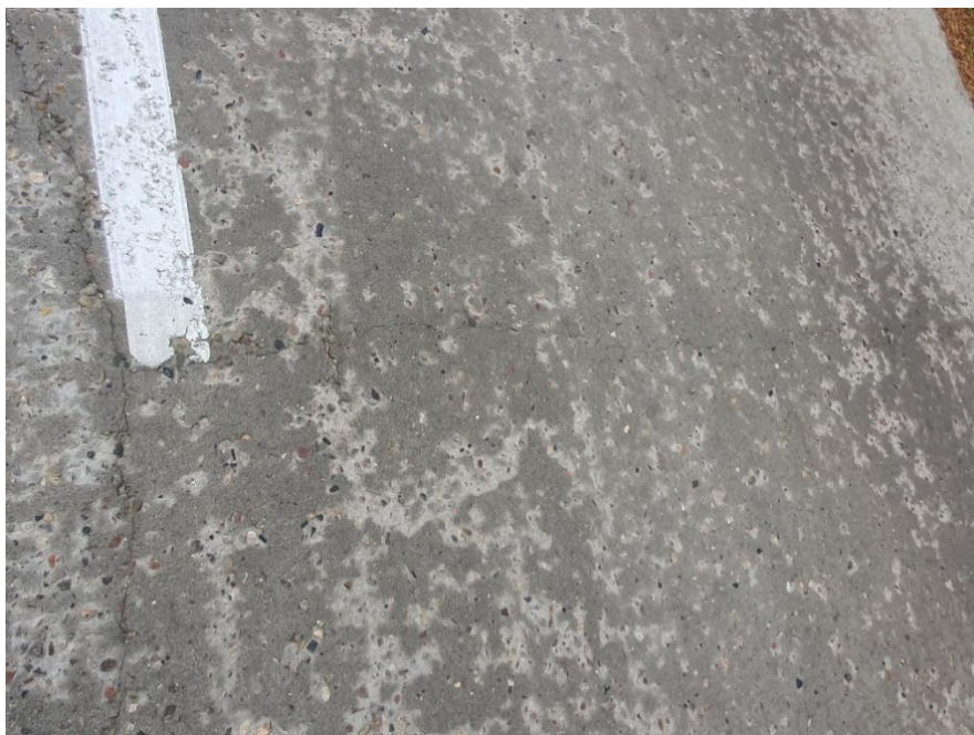
Rys. 43. Wygląd drogi betonowej po roku użytkowania z nieprawidłowo dobranym stosem okruszowym. Zdjęcie autora.
