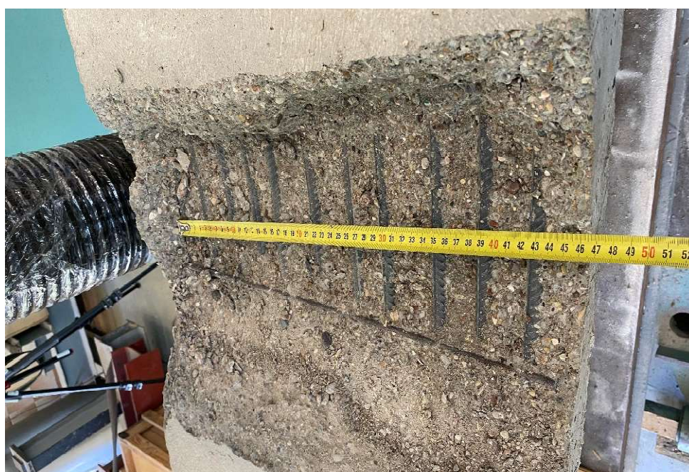
Rys. 41. Obraz zniszczenia płyty o dużym stopniu zbrojenia.
