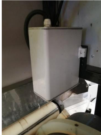
Rys. 20. Miejsce montażu czujnika CS1-P3611 w obudowie hermetycznej
