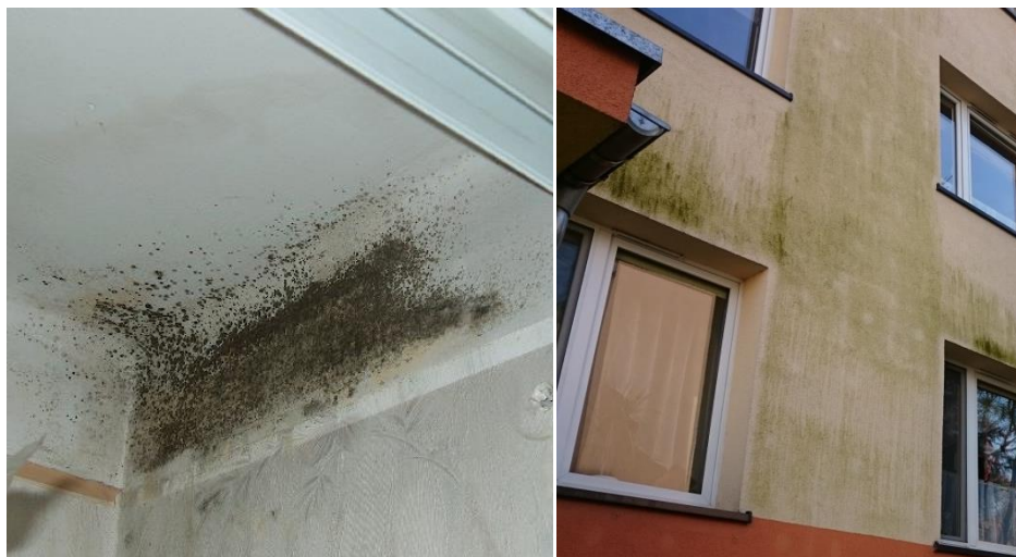
Rys. 1.2. Przykłady korozji biologicznej przegród budowlanych [Sosnowska 2015]
