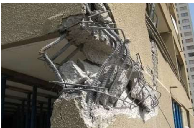
Fot. 1. Przykład utraty stateczności prętów w budownictwie [wynalazca.tv]
