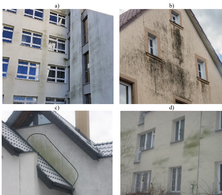
Rysunek 27. Biokorozja na elewacjach: a) narożnik ściany, b) podokienniki, c) obróbka blacharska dachu, d) powierzchnia źle zatartego tynku (archiwum autora)
