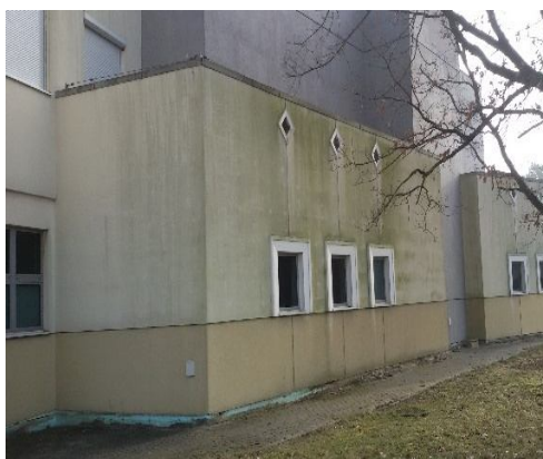
Rysunek 15. Zanieczyszczona elewacja w sąsiedztwie drzew (archiwum autora)
