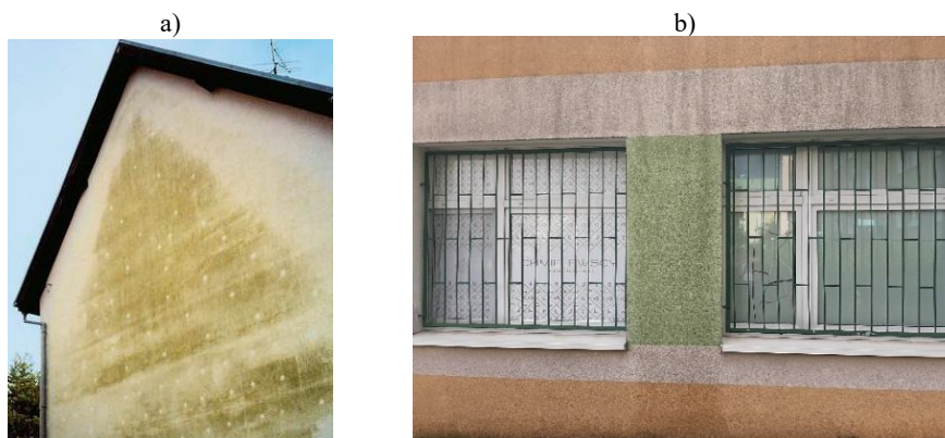
Rysunek 29. Elewacja narażona na: a) zacinający deszcz, b) deszcz spływający po ścianie (archiwum własne)
