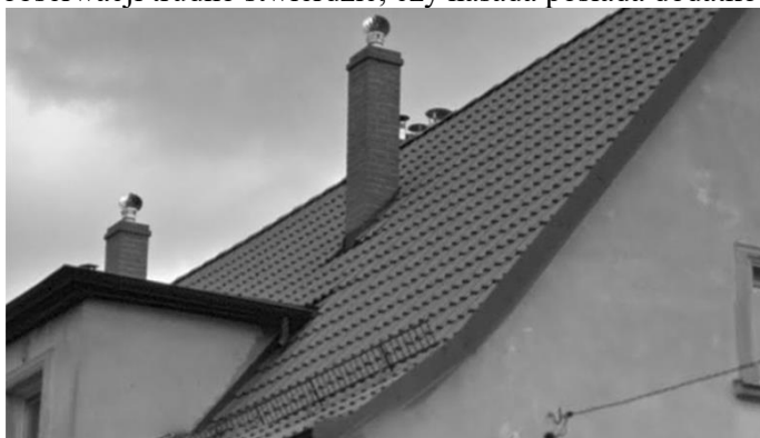
Rys.86. Nasada kominowa typu obrotowego. Budynek jednorodzinny w zabudowie szeregowej Gdańsk, ul. M. Karłowicza.
