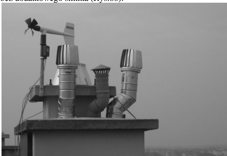
Rys.87. Nasada kominowa typu obrotowego. Budynek wielorodzinny (komunalny) Gdańsk, ul. Kampinowska
